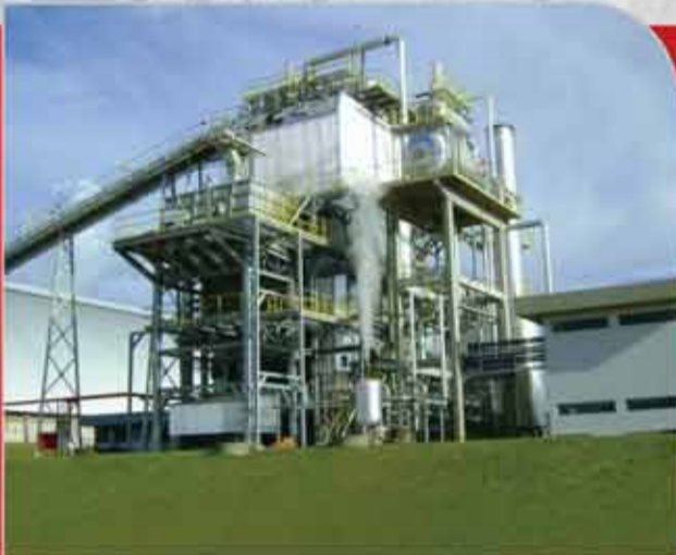
Caldeira BGV65000CA Pressão 67 kgf/cm 2 - Temperatura do Vapor 480°C
