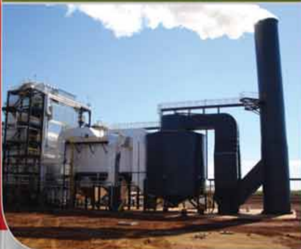
Caldeira BGV/M-130-BA Pressão 67 kgf/cm 2 - Temperatura do Vapor 480°C
